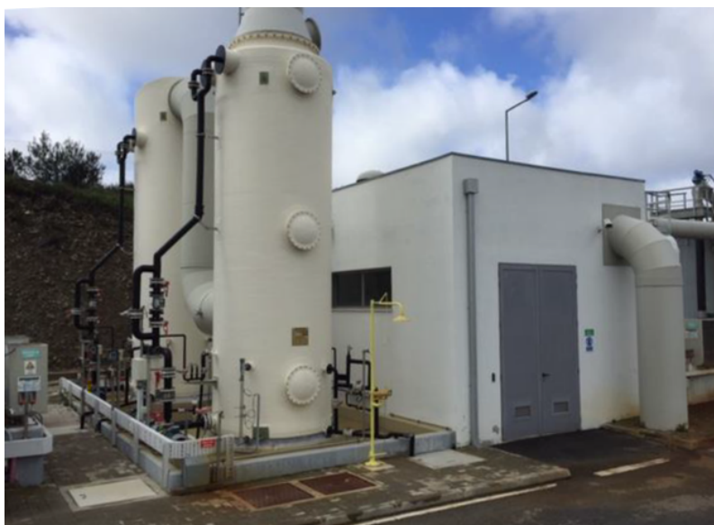
Figura 4.5: Desodorização da ETAR de Castelo Branco
