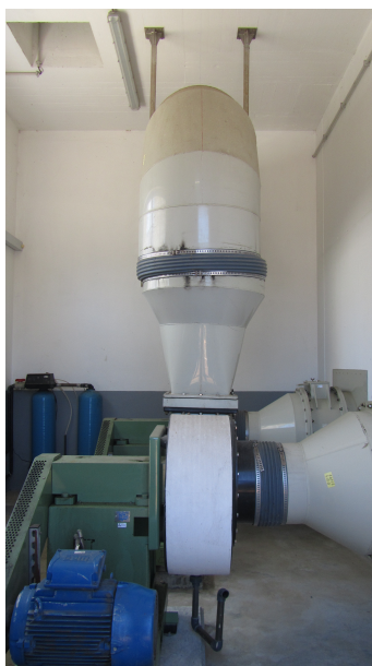
Figura 4.4: Ventiladores da ETAR de Castelo Branco
