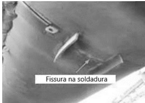
Figura 22 – Propagação de uma fissura na soldadura [41]
