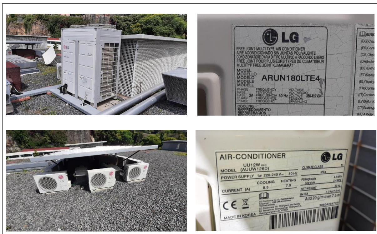
Figura 17 – a) VRV Piso 0; b) Chapa características VRV Piso 0; c) Sistema Split – Quartos Piso 1; d) Chapa características sistema Split.
