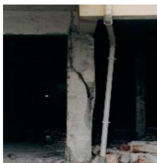
Figura 2.14 - Rotura por esforço transversal de um pilar, [adaptado de (Marques 2012)]. .
