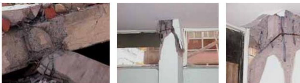
Figura 2.17 - Pormenorização deficiente da armadura, [(Varum 2008)].
