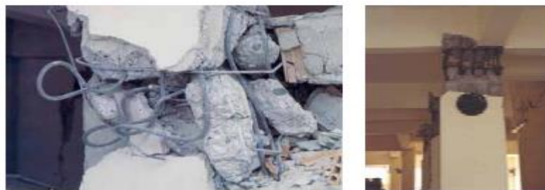
Figura 2.16 - Pilares de betão armado com inadequado confinamento, [adaptado de (Varum 2008)].
