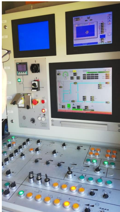
Figura 6.15 – Cabine do piloto da tuneladora.
