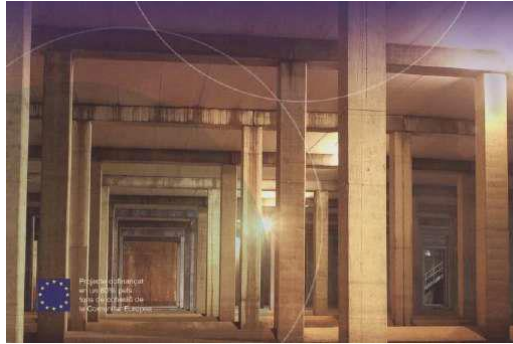
Figura 4.7 – Reservatório enterrado em Barcelona capacidade (35 000 m 3 )(J. S. Matos et al., 2015).
