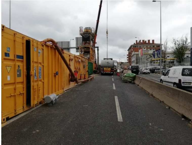
Figura 6.12 – Imagem do equipamento apoio a tuneladora).
