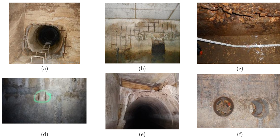
Figura 6.35 – Patologias Nova II: a) Acesso ao coletor com armaduras à vista; b) Delaminação do betão; c) Armaduras totalmente corroídas; d) Pouco recobrimento; e) Transição de coletores com resto de cofragem; f) Entradas de água obstruídas.
