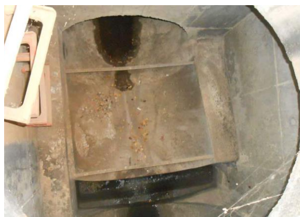
Figura 6.26 – Caixa existente na rua dos Argonautas.
