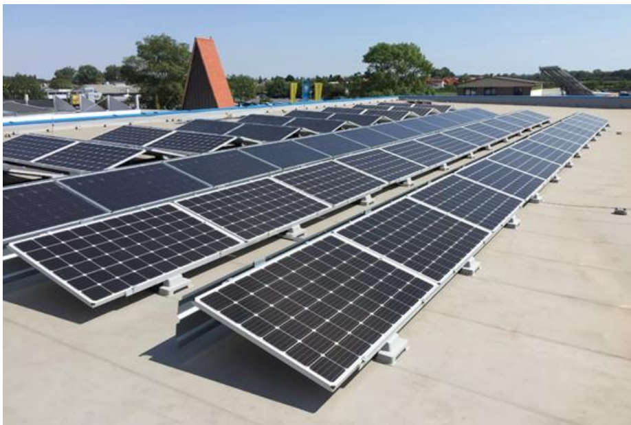
Figura 2.9 – Exemplo da instalação de painéis fotovoltaicos [50]
