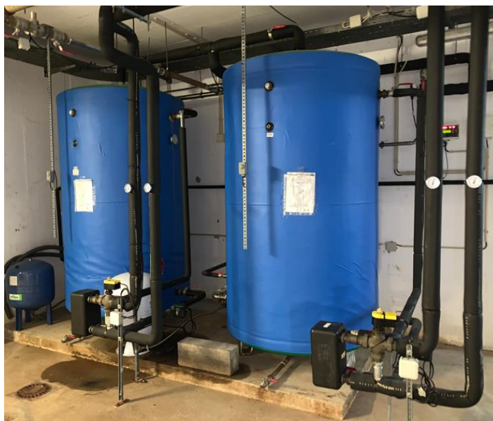
Figura 23 – Depósitos de AQS presentes na piscina Vale do Fundão
