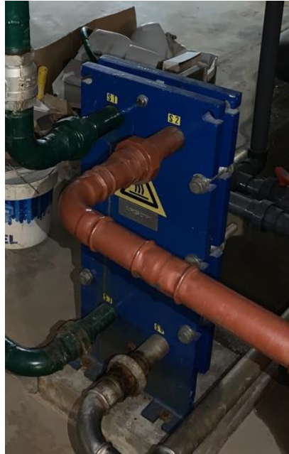
Figura 18 - Permutador de placas (Piscina municipal Vale do Fundão)
