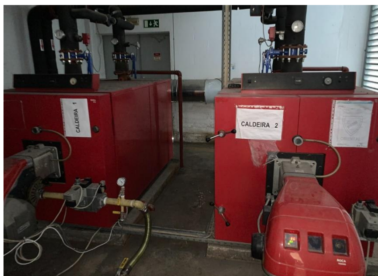
Figura 21 - Caldeira presente na piscina Vale do Fundão
