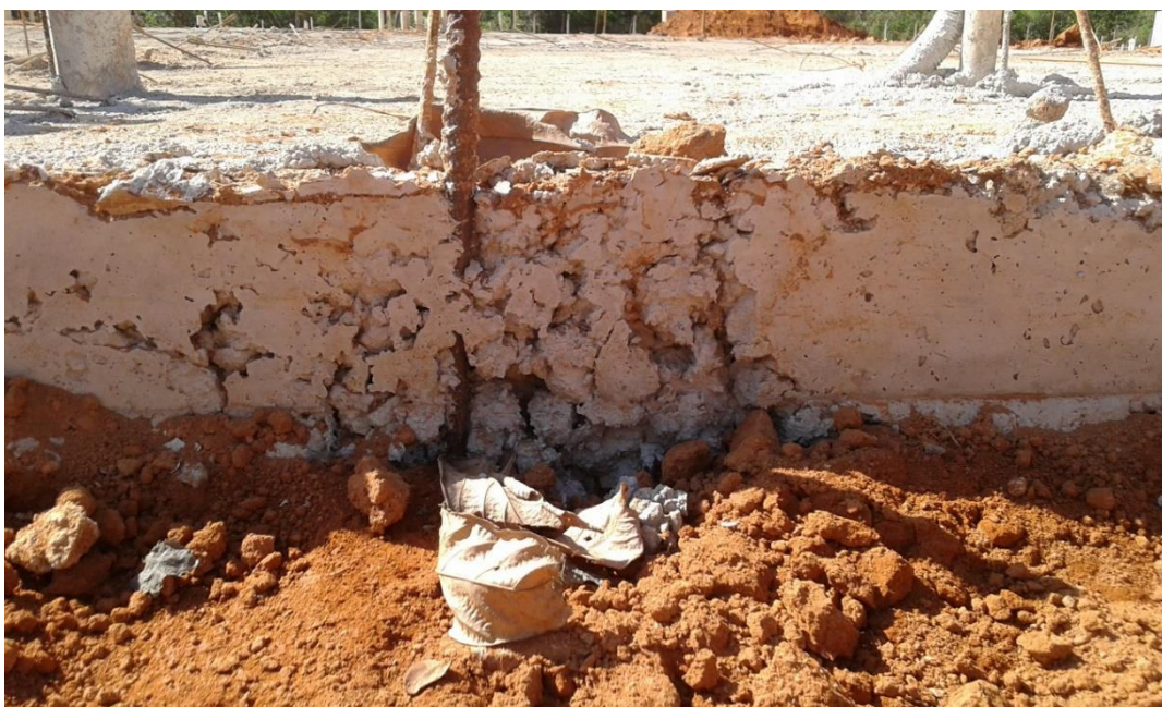
Figura 5.80 – Falta de adensamento
