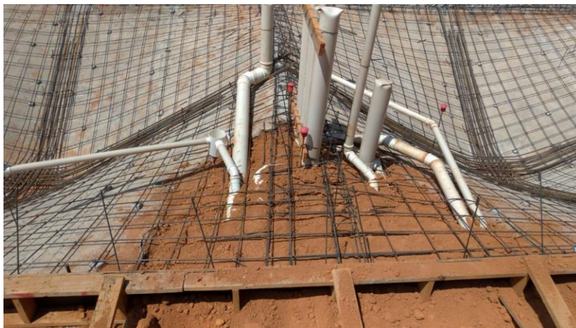
Figura 5.82 – Armaduras em contato com o solo na zona das tubagens
