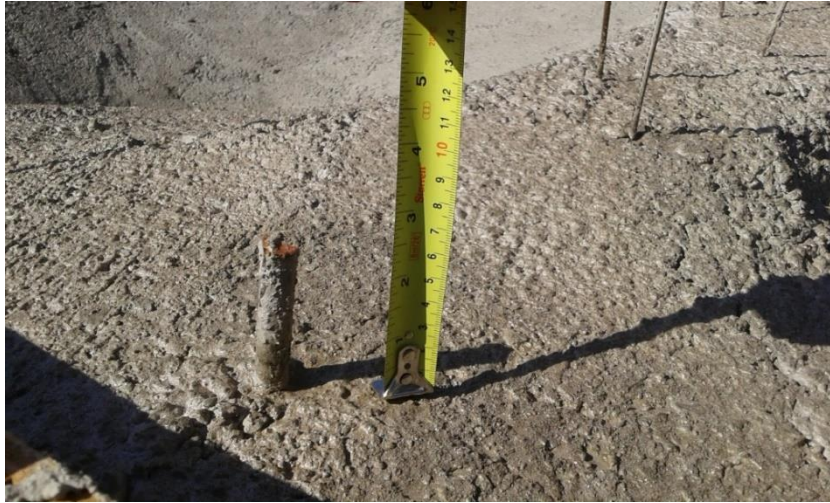
Figura 5.81 – Não conformidade na primeira etapa de betonagem
