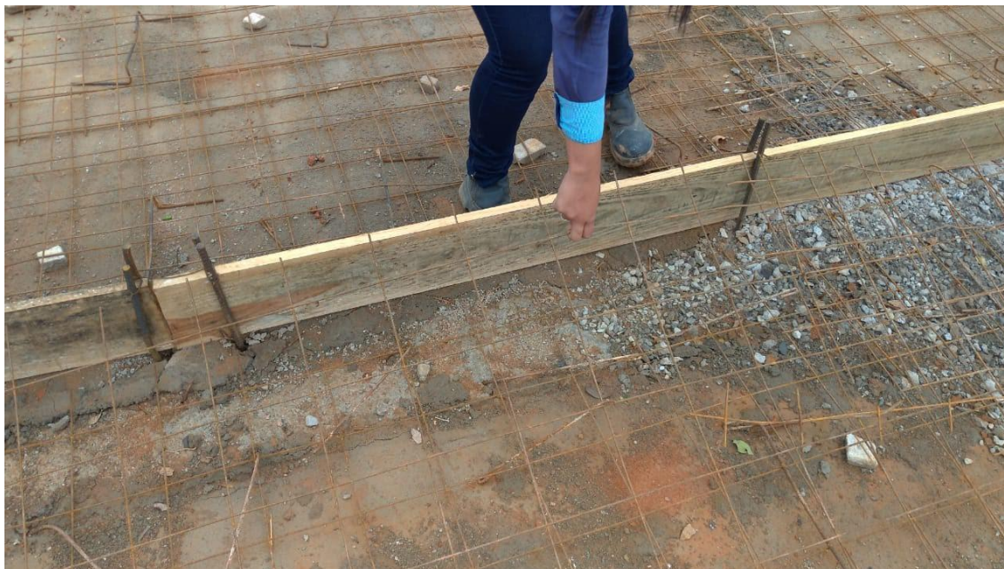
Figura 5.85 – Falta de amarrações e espaçadores nas armaduras
