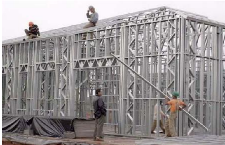
Figura 2.18 – Sistema construtivo Steel Frame (Passini et al., 2014)
