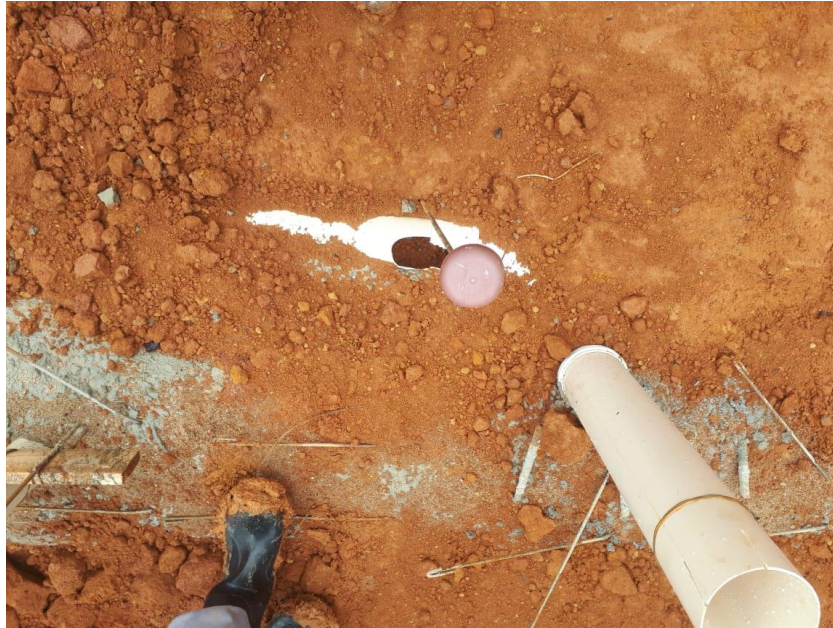
Figura 5.83 – Tubagens das instalações hidráulicas danificadas
