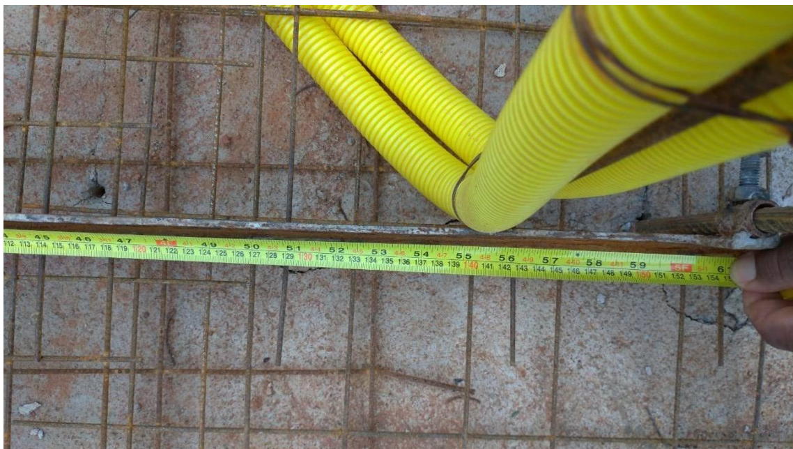
Figura 5.84 – Locação errada dos eletrodutos
