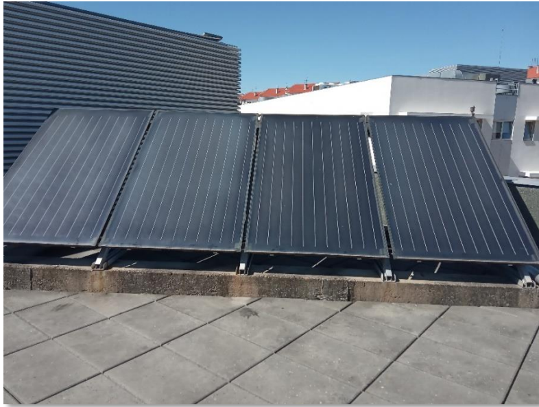
Figura 33 - Painel solar de um edifício particular [Fonte própria, 2019]
