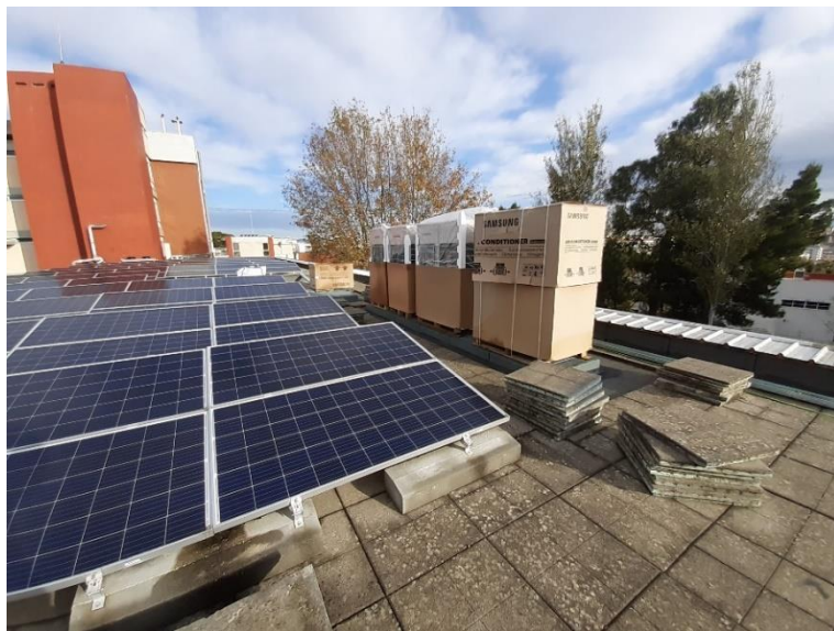
Figura 34 - Central fotovoltaica de uma instituição pública de saúde [Fonte própria, 2021]
