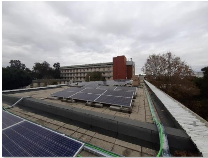
Figura 25 - Instalação fotovoltaica [Fonte própria, 2019]
