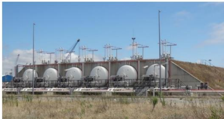
Figura 3.2 - Exemplo dos Reservatórios do Parque de Combustíveis.
