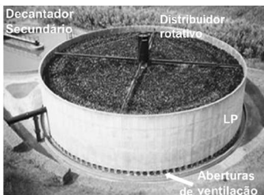
Figura 3.1 Leito percolador e decantador secundário
