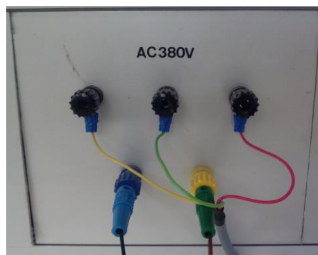
Figura 3.3 – Rede trifásica do laboratório;
