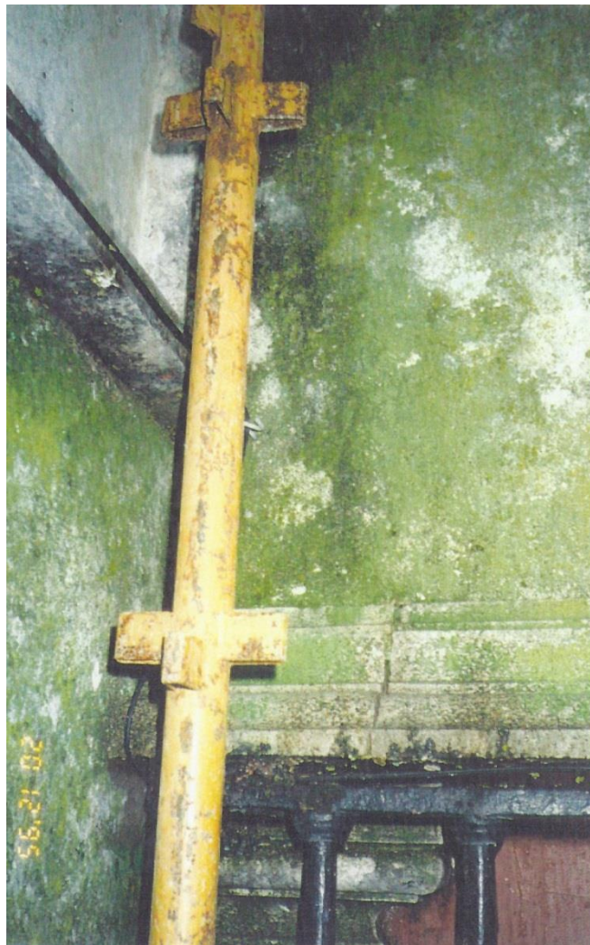
Fig. 4.2. – Algas/Verdetes sobre Reboco (1995)
