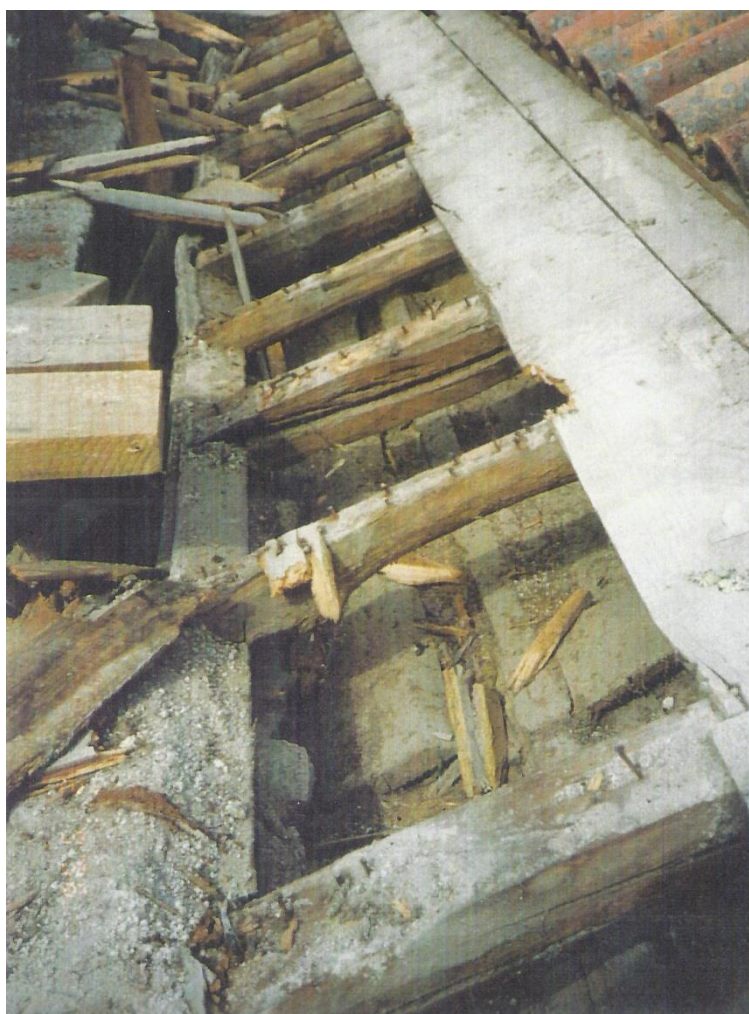
Fig. 4.16. – Apodrecimento de Madeiras em Cobertura (1996)
