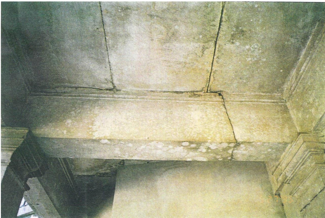
Fig. 3.9 – Fractura de Viga em Cantaria (1995)
