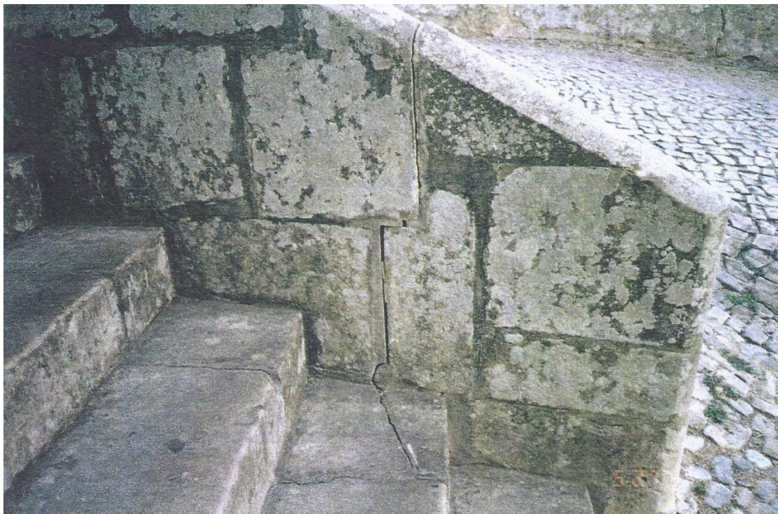
Fig. 3.13. – Deslocamento em Guarda de Escada - Fachada Principal (1995)
