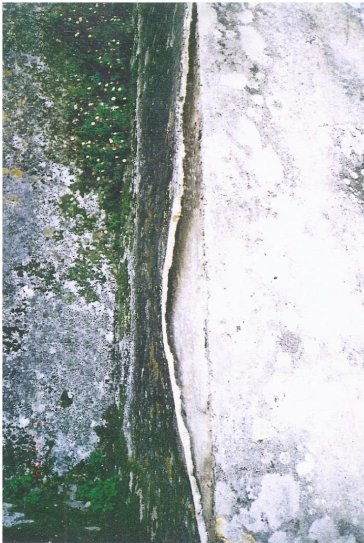
Fig. 3.6 – Destacamento de Reboco sobre Cantaria (1995)
