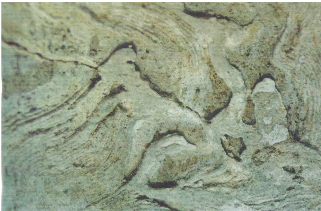
Fig. 3.4. – Lixiviação de Rebocos (1996)
