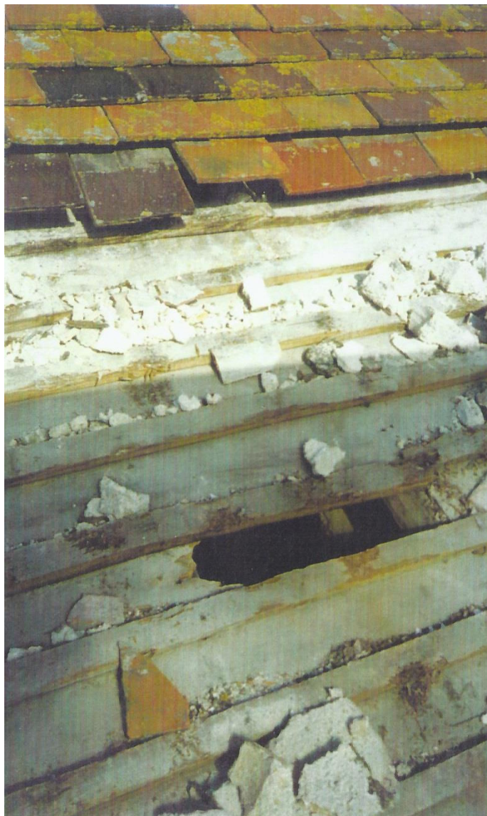
Fig. 5.13. – Degradação de Ripado e Forro (1996)
