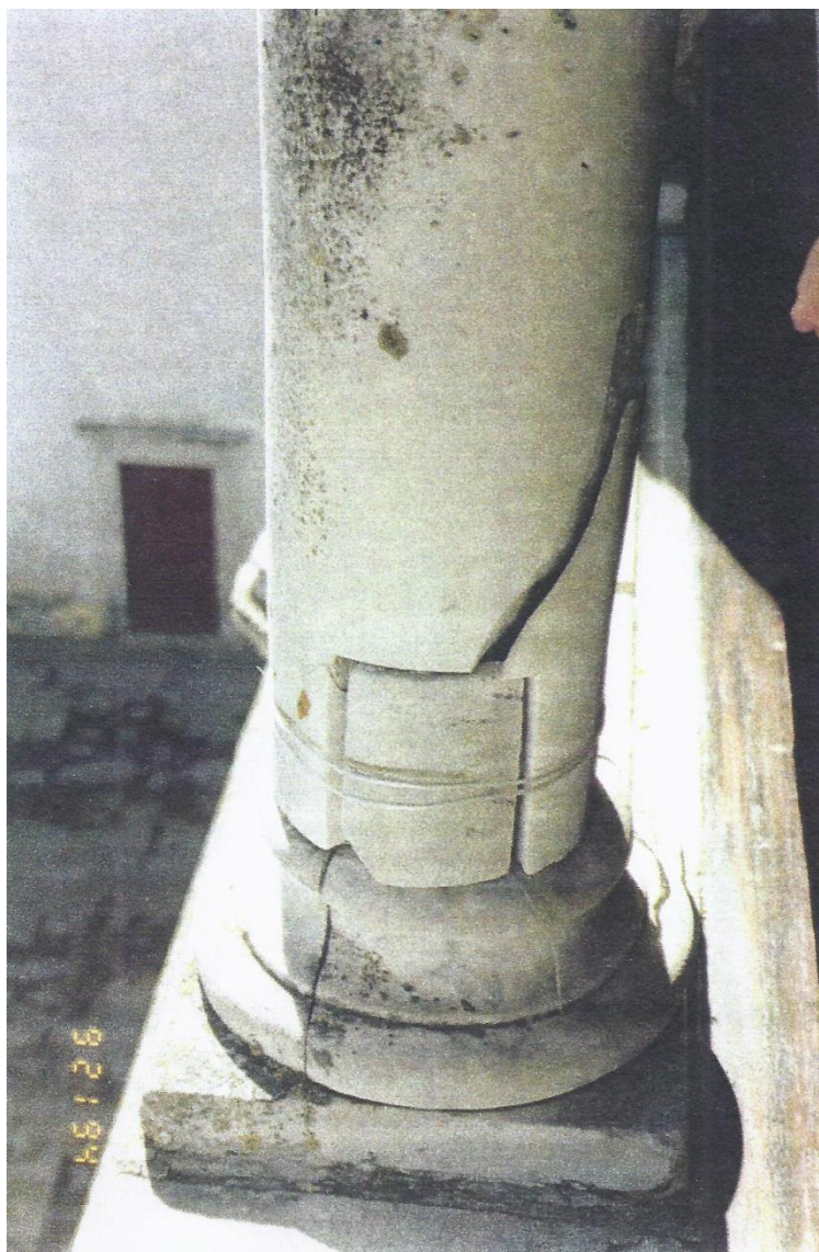
Fig. 4.15. – Rotura de Mainel – Oxidação de Elementos Metálicos Interiores (1994)
