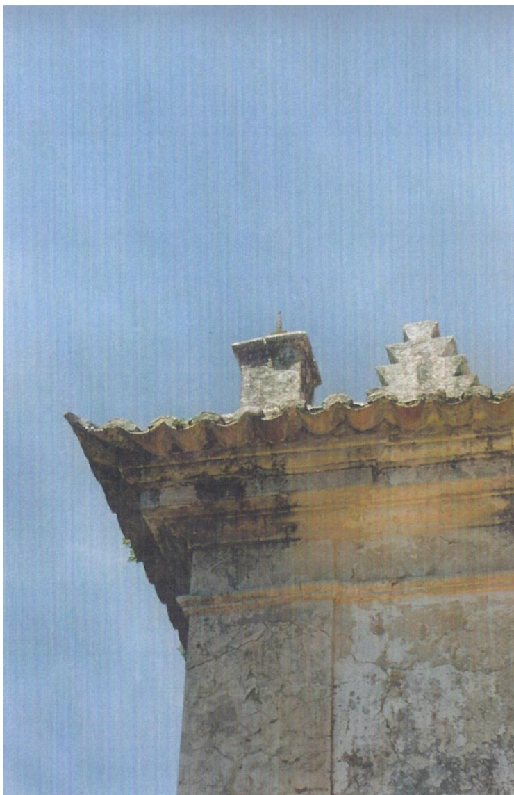
Fig. 4.5. – Fissuração e Fendilhação em Cunhal (1995)
