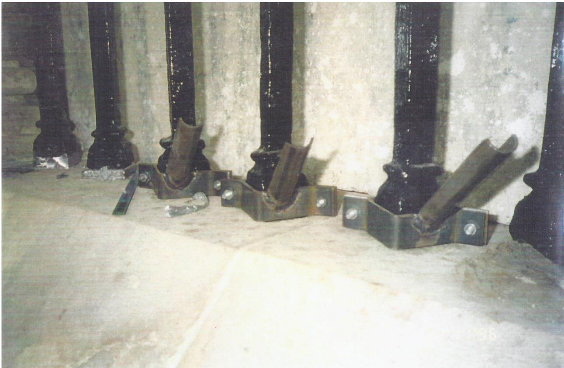
Fig. 5.19. – Vazamento de Chumbo – Fixação de Guarda Metálica (1996)
