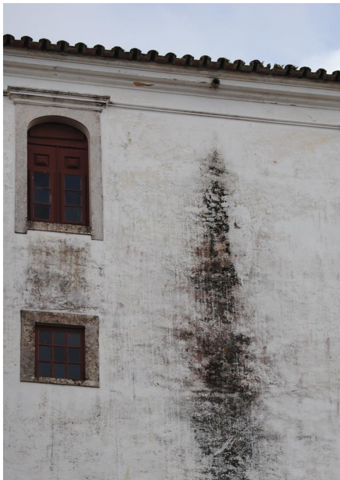
Fig. 6.1. – Escorrência de Águas Pluviais sob Gárgula (2013)
