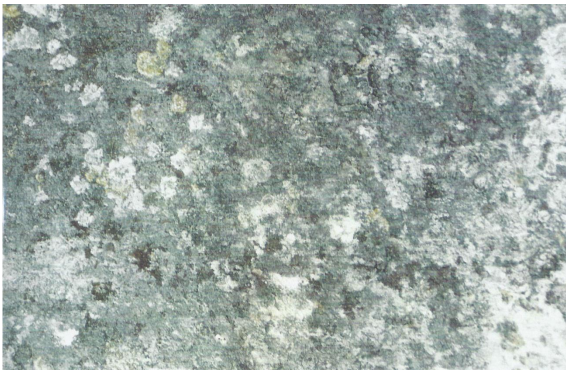
Fig. 4.4. – Rebocos das Chaminés (1995)
