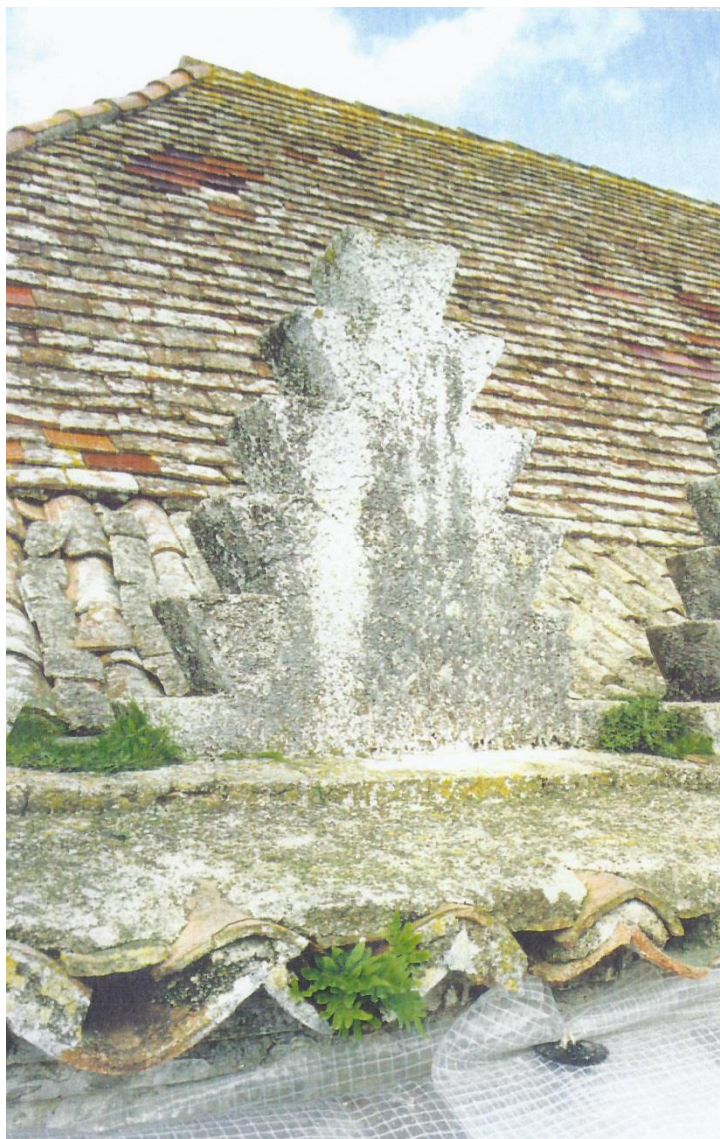
Fig. 3.17. – Colonização Biológica – Melrões e Beirado – Fachada Principal (1996)
