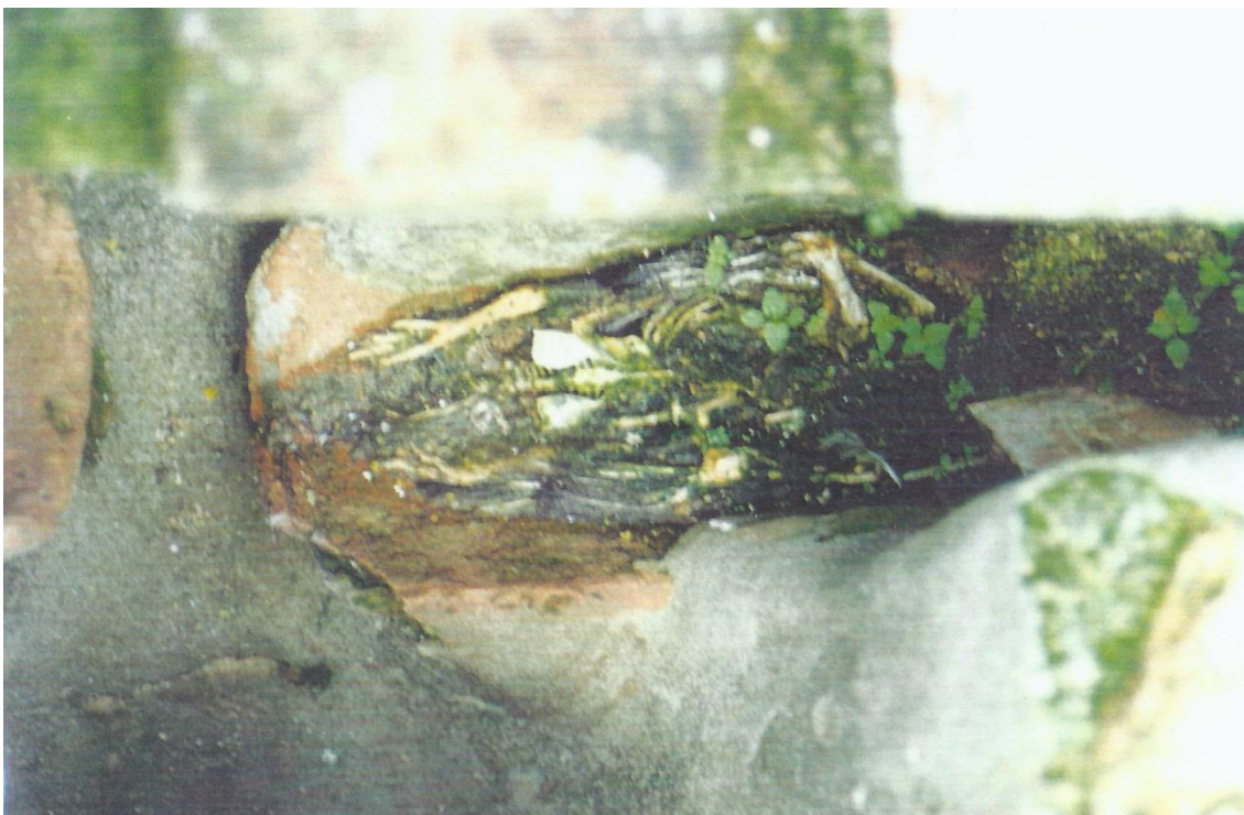
Fig. 4.19. – Acumulação de Detritos em Algeroz (1996)
