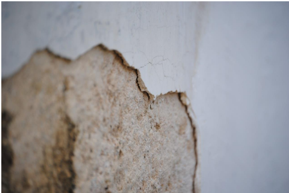
Fig. 6.3. – Destacamento de Reboco (2013)
